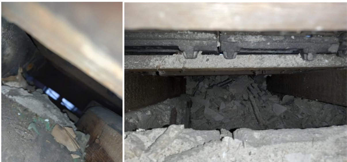
Figuur 4.4.2. De lege ruimtes tussen het dak en de gevel zijn te open en daardoor te tochtig voor vleermuizen.
