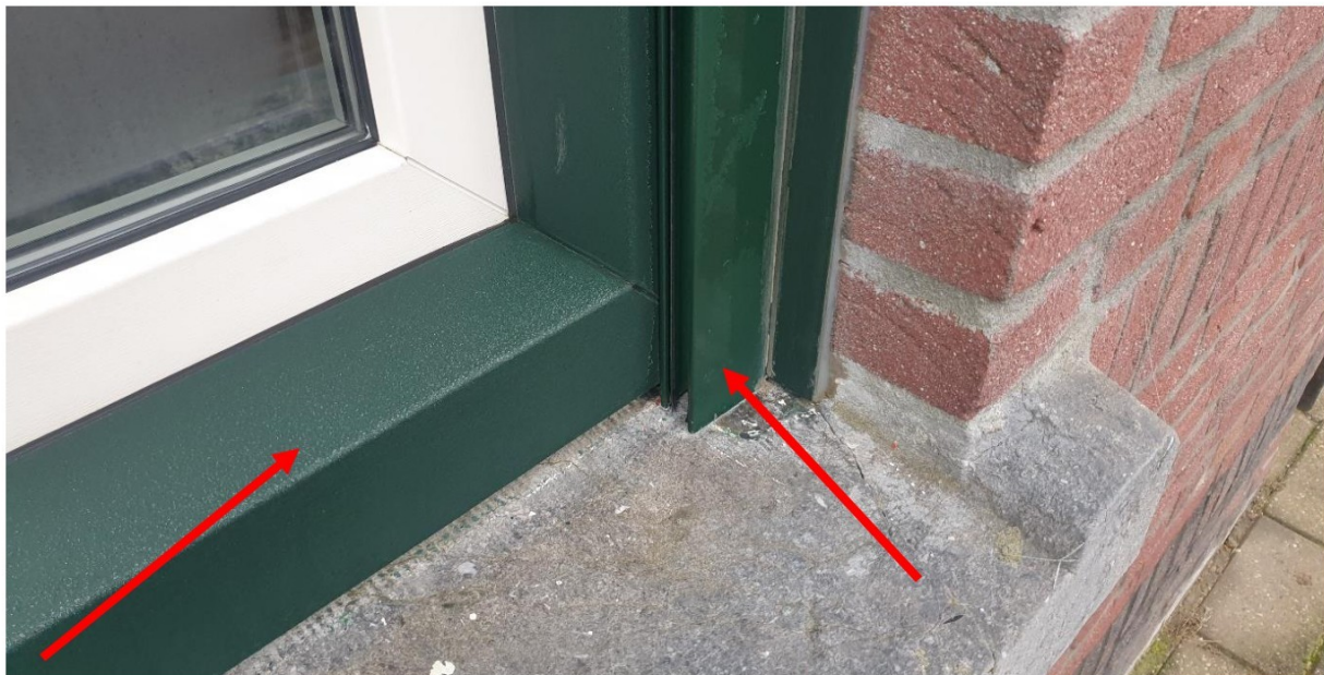
Kunststof kozijnen met verkeerde profielvorm. Rolliikgeleiding in de voorgevel
