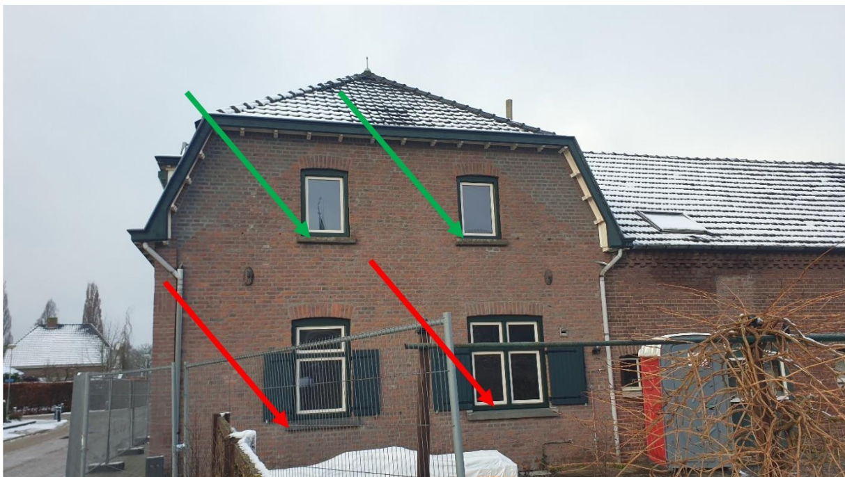
Op de begane grond zijn moderne raamdorpelstenen toegepast onder de kozijnen welke niet authentiek zijn voor deze woning. Op de verdieping lijken ze wel authentiek.
