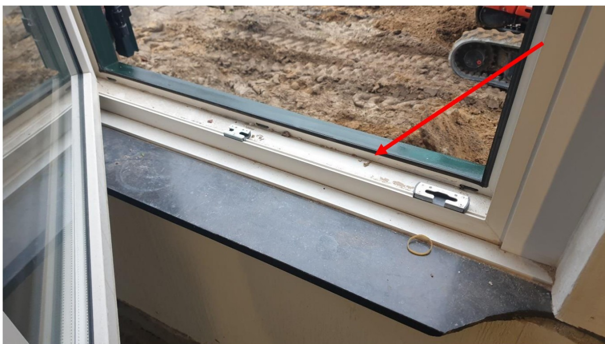
Kunststof kozijnen met verkeerde profielvorm.
