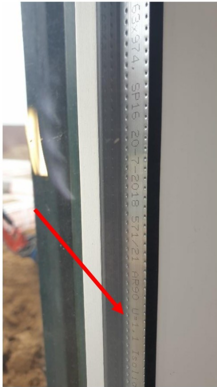
Gebruik van standaard HR++ ramen in de kozijnen van de gevels is niet authentiek.
