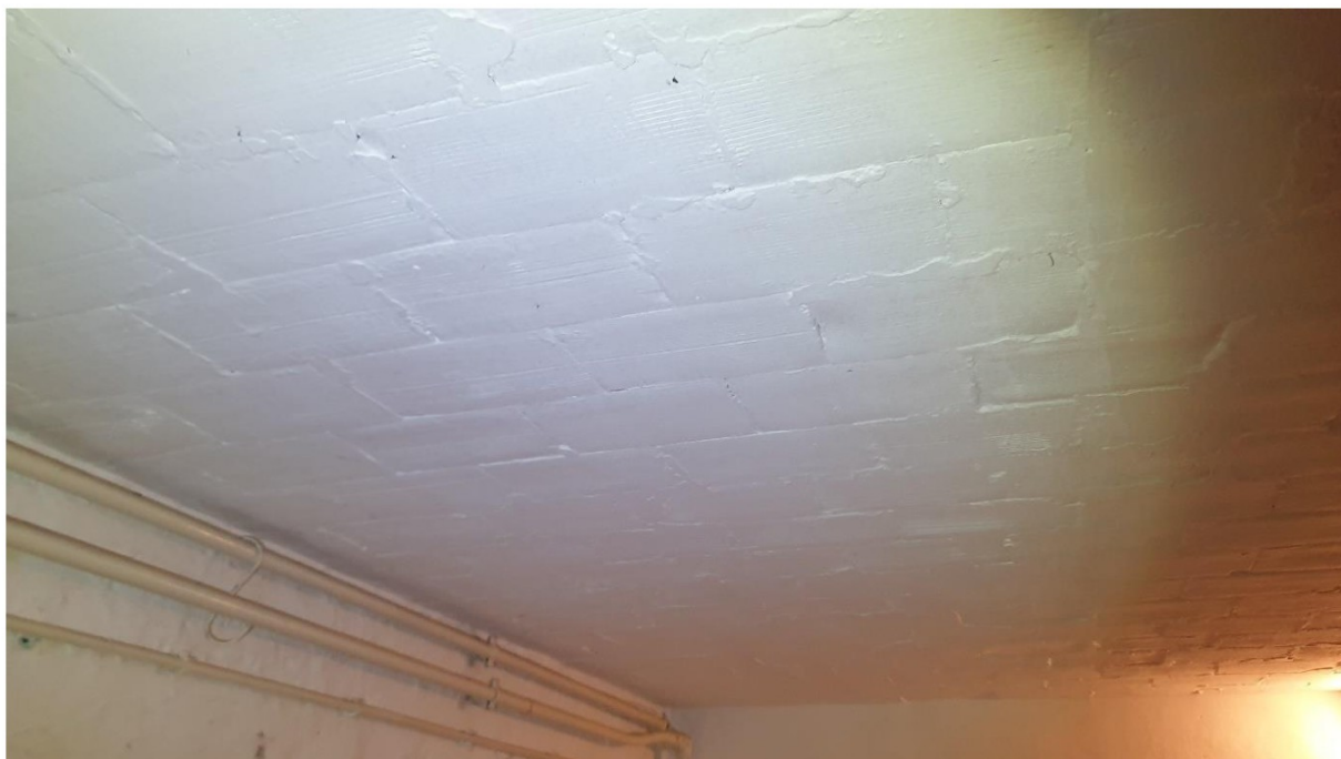
Plafond "nieuwer" kelderdeel
