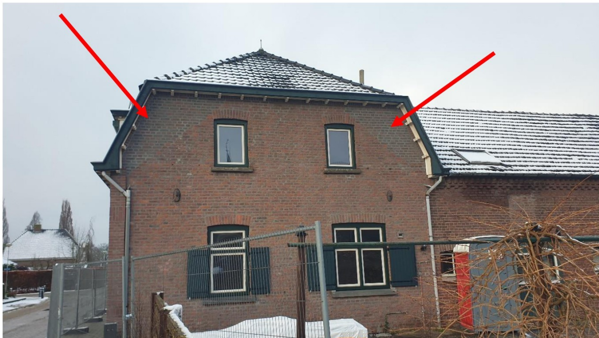
Opgemetseld deel van de gevel waarbij gebruik is gemaakt van een niet authentieke steen.
